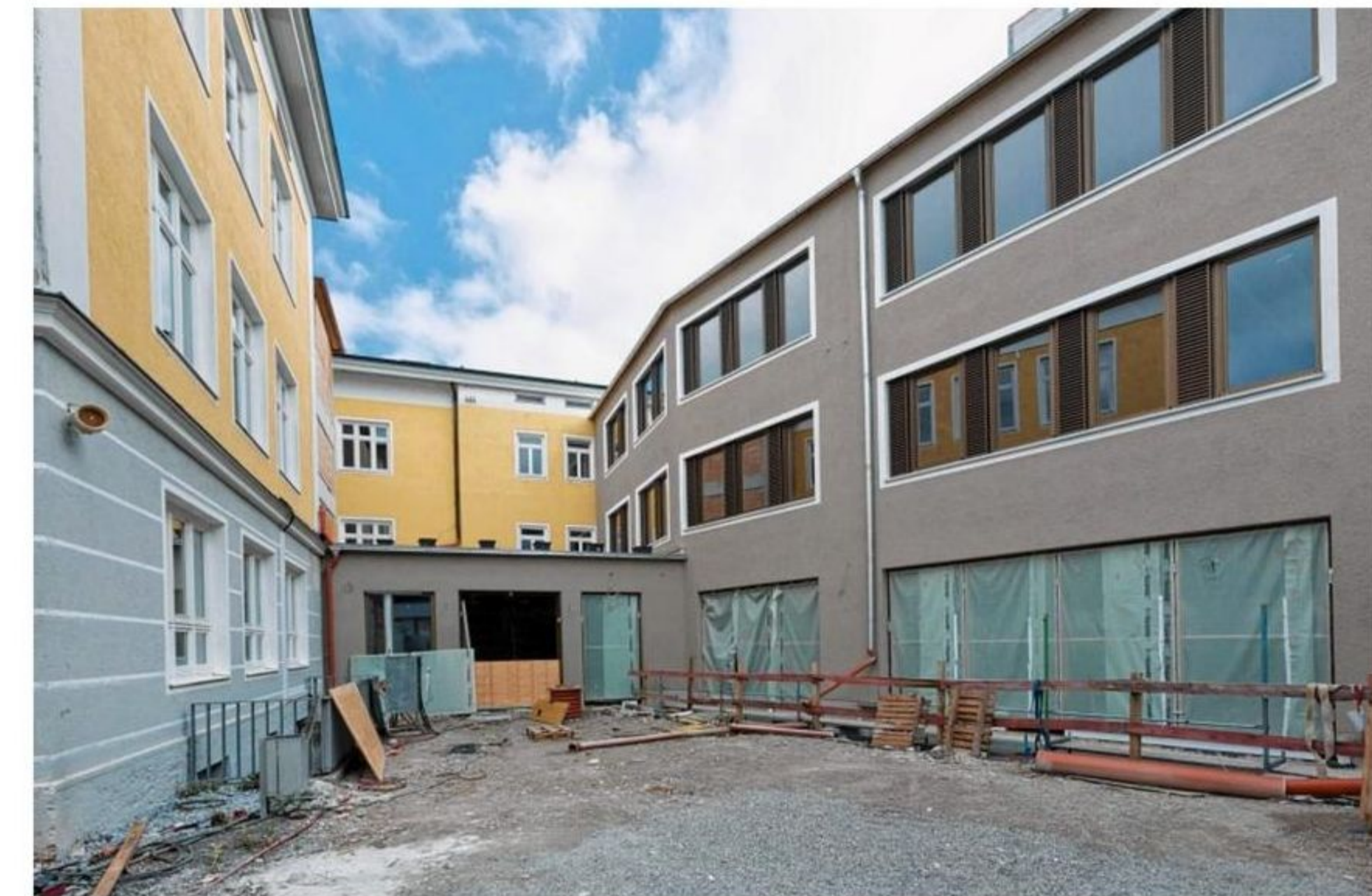
Vom Altbau in den Neubau – um die Weihnachtszeit werden Handwerker und Schüler die Räume tauschen: Die Kommunale Realschule zieht Übergangsweise um in den neuen Anbau, der ab 2017 die Staatliche Realschule beherbergen wird.
